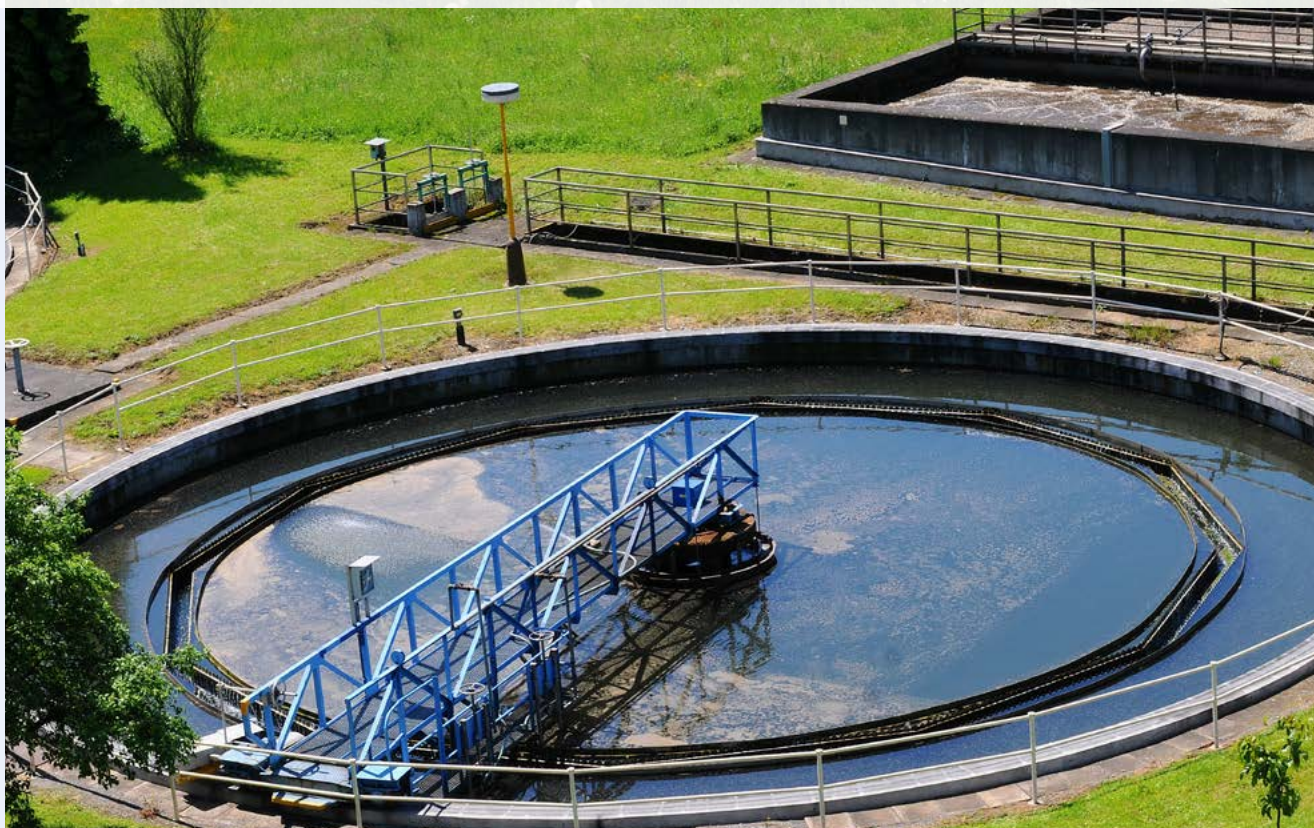
Čistírna odpadních vod v Českém Těšíně dokáže za rok vyčistit 3,65 milionu metrů krychlových odpadní vody, což představuje ekvivalent pro 30 tisíc obyvatel. Uvedena do provozu byla v roce 1973, postupně byla několikrát modernizována a rozšiřována.
